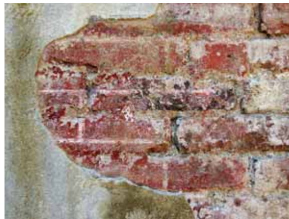
Obr. 9b. Ostrov nad Ohří, Palác princů. Vliv struktury cihelného zdiva lze sledovat až do 19. století. Tento příklad pochází ze sklonku 17. století, kdy byla cihla přetřena červeným nátěrem a na nerovném povrchu byla bílou linkou vykreslena iluzivní cihelná skladba. (Foto P. Macek, 2008)
