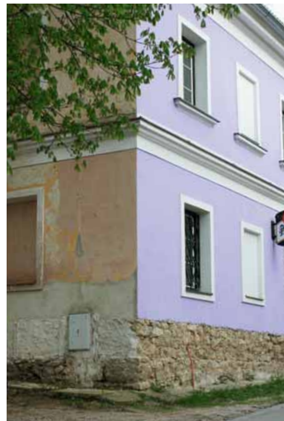
Obr. 42. Hojná Voda, čp. 28/1. Objekt i prostředí zásadně poškozuje barevnost nemající ke starším vrstvám a místnímu prostředí žádný vztah. (Foto V. Láška, 2008)
