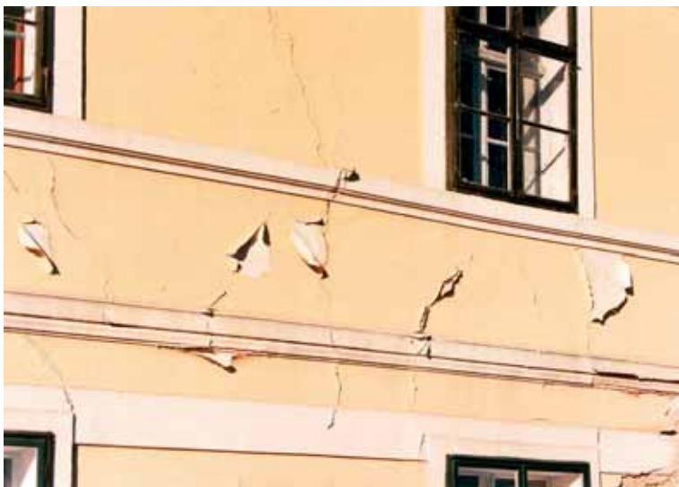
Obr. 41. Mirovice, sokolovna. Obnovu zásadně ničí nevhodně zvolená technologie, zvláště novodobé nátěrové systémy. (Foto M. Solař, 2002)
