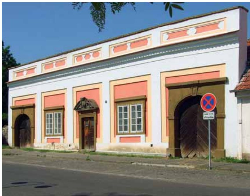
Obr. 52. Budyně nad Ohří, raně barokní špitál. Nevhodná obnova, snažící se navodit v tomto případě dojem barokní barevnosti, navíc opět bez vazby na kamenné patinované prvky. (Foto P. Macek, 2009)
