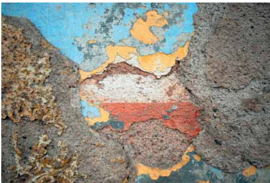
Obr. 35. Kuks, čp. 58. Nálezové situace jsou mnohdy značně složité; vyžadují vysoce odborný průzkum i následné vyhodnocení. (Zpracoval J. Beránek, 2008)
