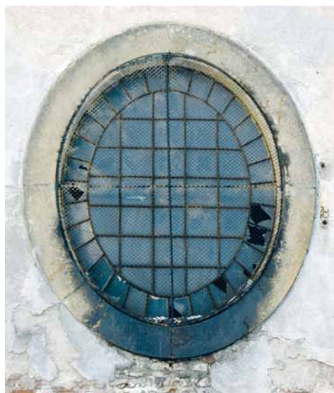
Obr. 46: Pozornost je třeba věnovat i starším ochranným sítím (Činovec – okres Teplice, kostel Nanebevzetí P. Marie; foto A. Schubert, 2012).
